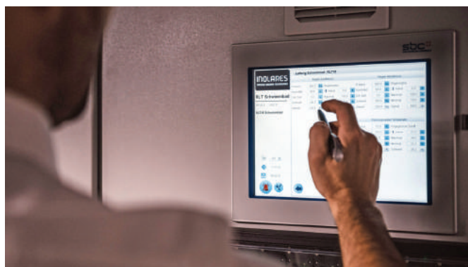
▲ Durch den Einbau der 12" Panels kann das Facility Management des Hotels problemlos Änderungen an den Einstellungen vornehmen und die Gebäudetechnik bedarfsgerecht steuern.
